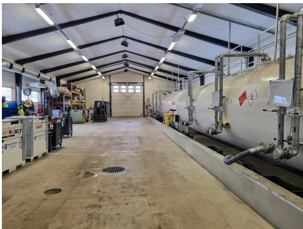
Kuva 2 Toimipaikka sisältä. Polttoainesäiliöt ovat suoja-altaissa ja säiliöiden täyttö ja polttoaineiden nouto tapahtuvat sisätiloissa.
