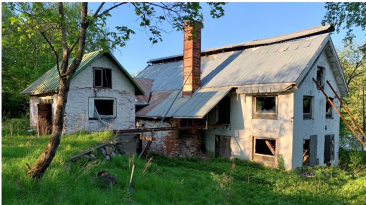
Myllyyn on kohdistunut tuhopolttot 2009 ja ilkivaltaa. Katto on uusittu väärin ja on romahtanut.
