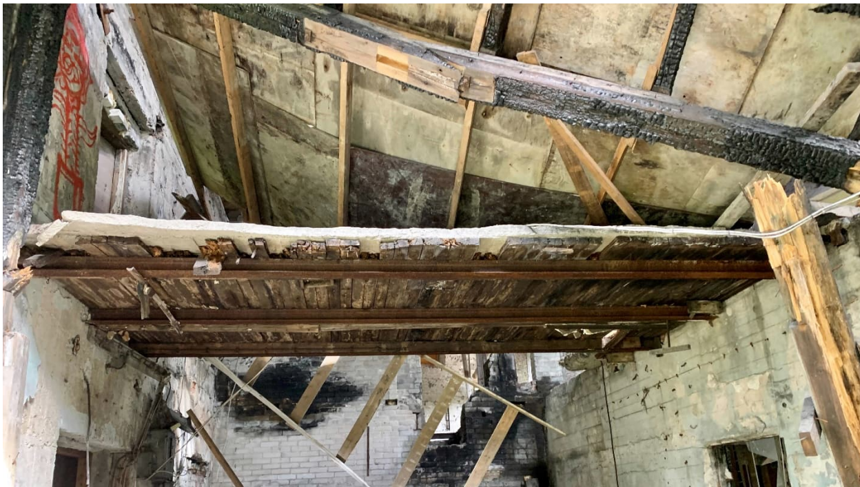
Myllyn katto on tehty väärin, palkki on haljennut ja katto romahtanut. Sisällä ollut tulipalo jälleen elokuussa 2021. Korjattuna salista tulee juhlatila. TKa 20.8.2021
