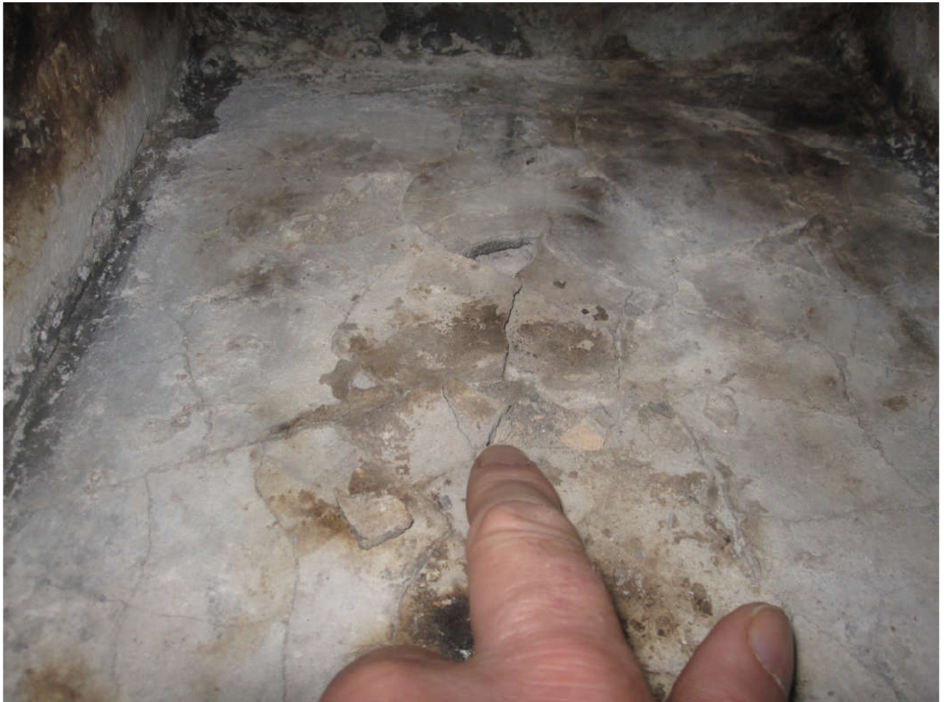
Kuva 6. Takan pohjan halkeilua (loppukatselmus 20.8.2019)
