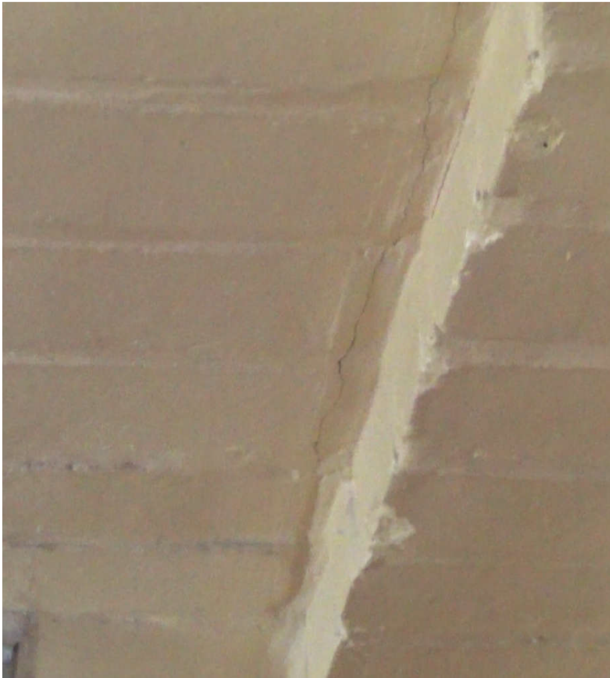
Kuva 7. Takan peilin oikean reunan pysty hiushalkeama (kuvakaappaus alkukatselmusvideolta 2.5.2017)
