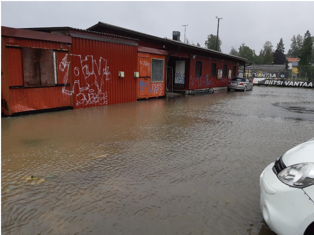
Kuva 12. Pellaksenojan tulvimisen seurauksena aiheutui kosteusvaurioita Vantaan kaupungin urheilukentän pukutiloille elokuussa 2023 (Vantaan kaupunki)
