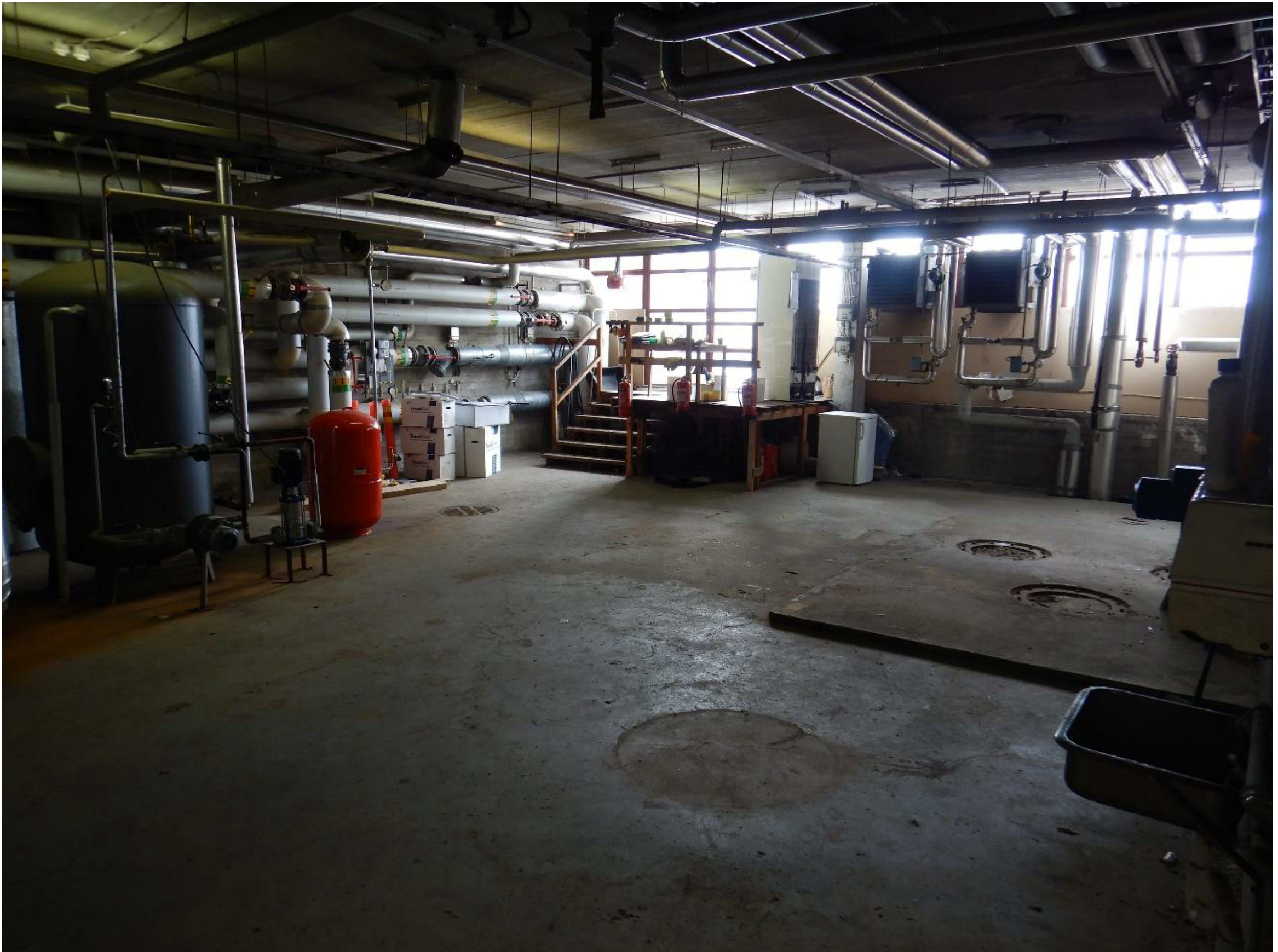
Kuva 10. Paloilmoitinkeskus, yleiskuva rakennuksen sisältä.
