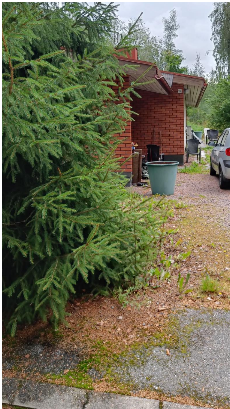
Kuva 1. Saavien ylitäyttöä ei ole estetty (22.8.2023).
