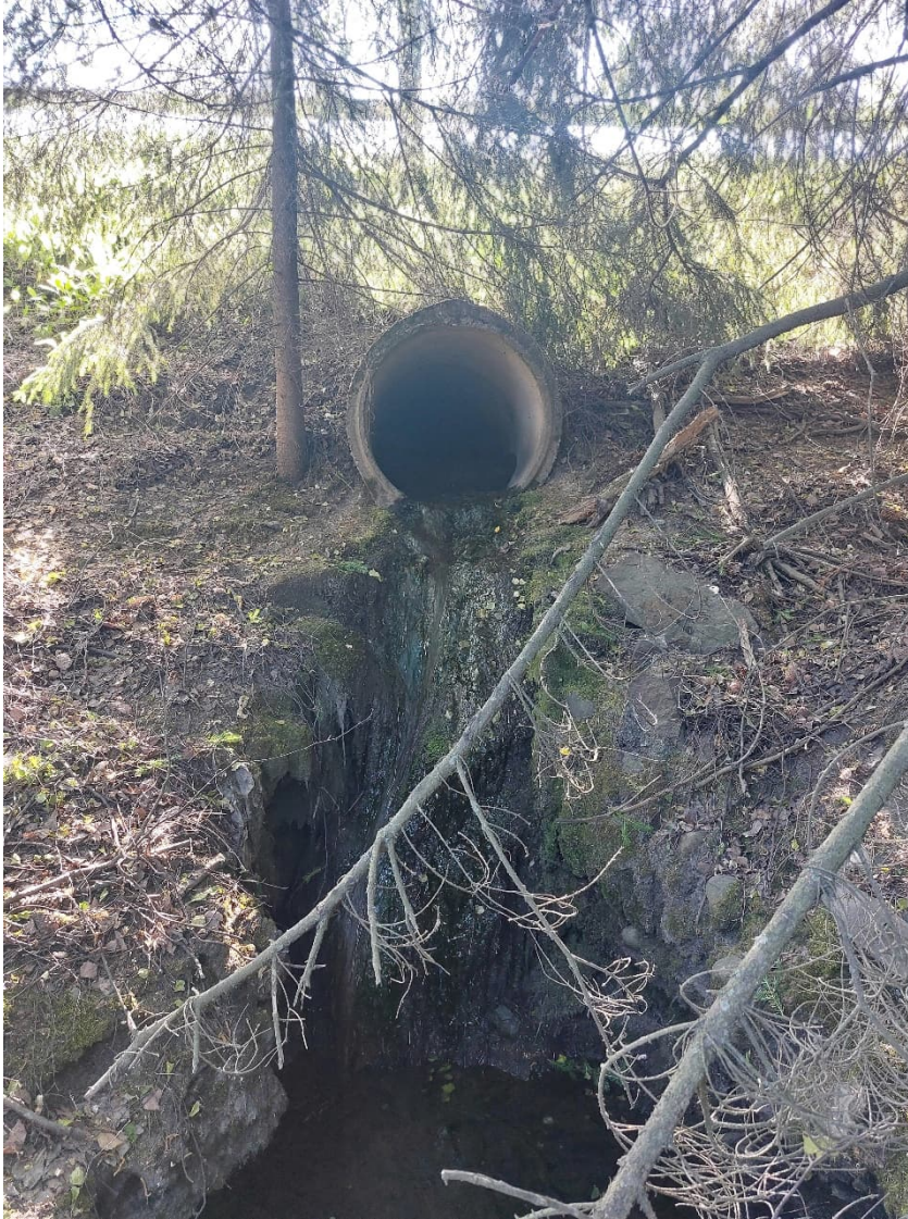
Kuva 7 Vanhan Porvoontien alittava DIA 800 hulevesiputki suunnittelualan puolelta (Kuva: Johanna Pajari)
