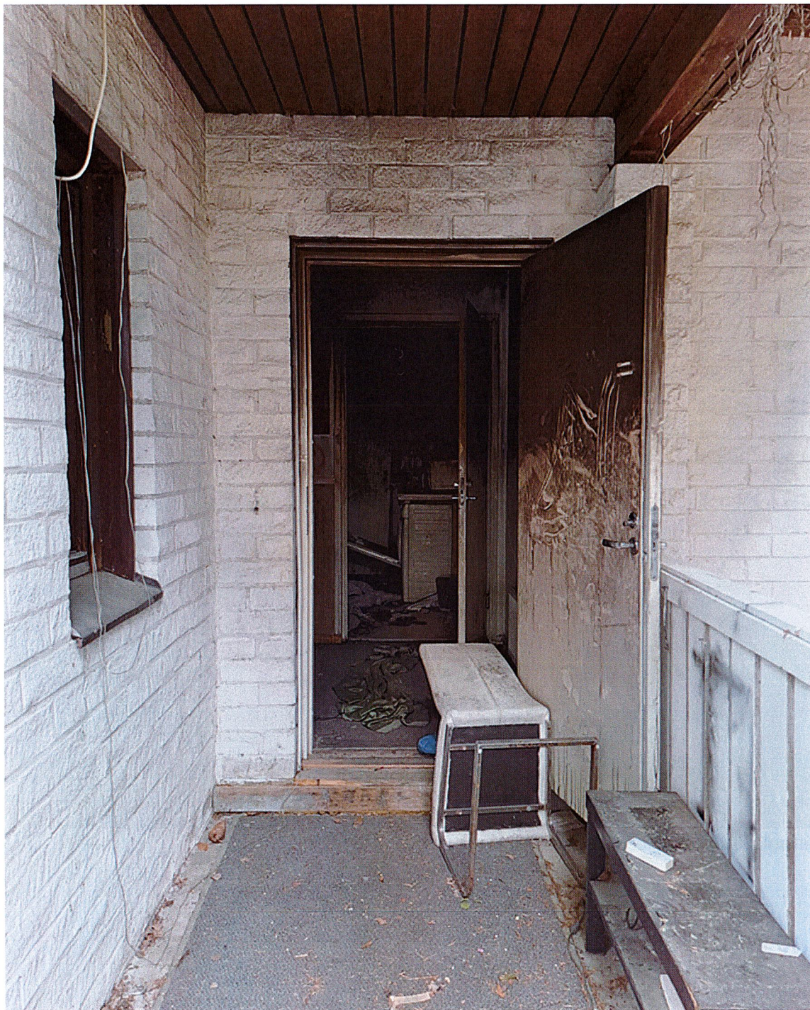
Kuva 2: Rakennuksen etuovi auki ja levällään.
