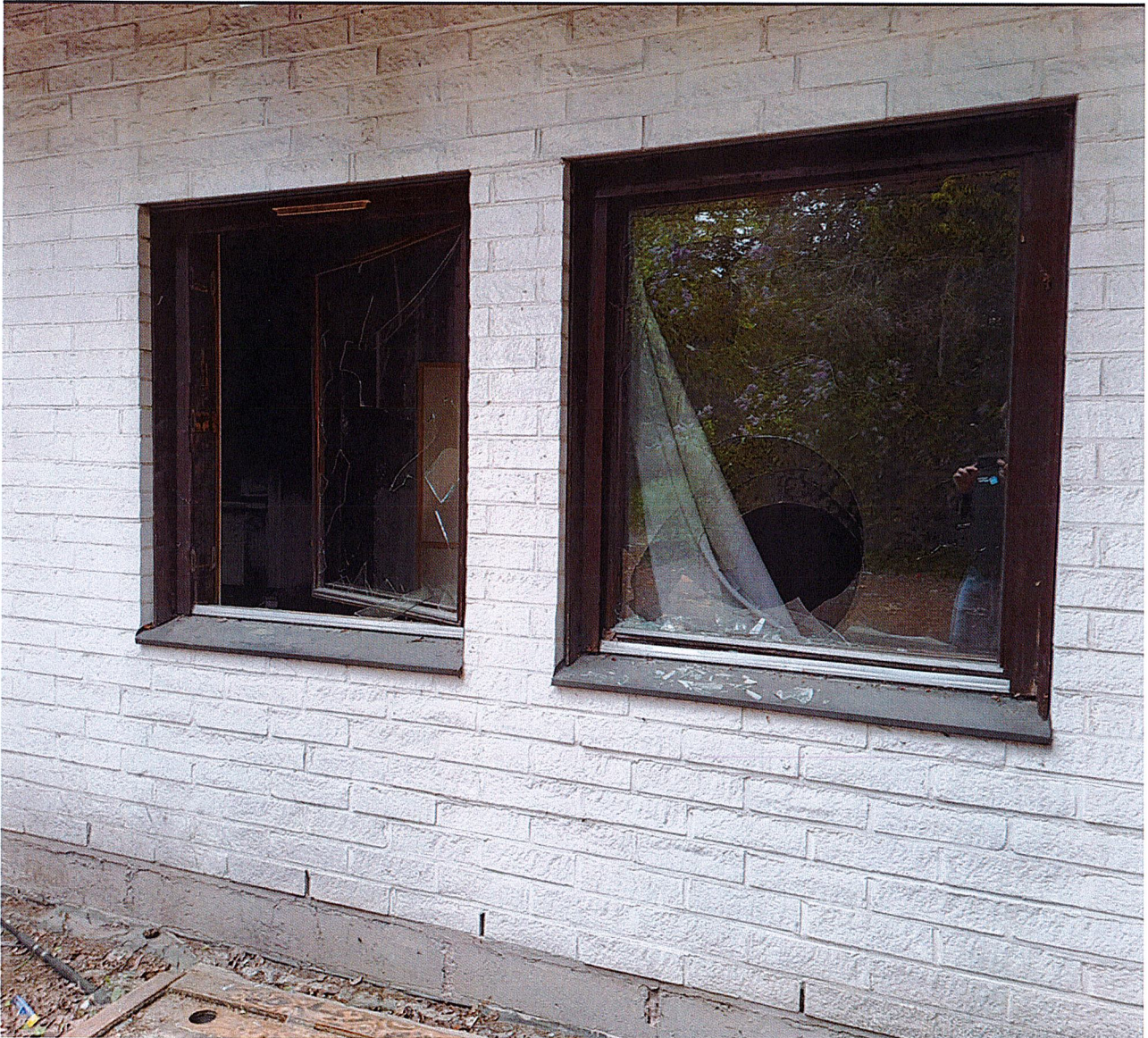
Kuva 3: Rakennuksen ikkunat on rikottu.
