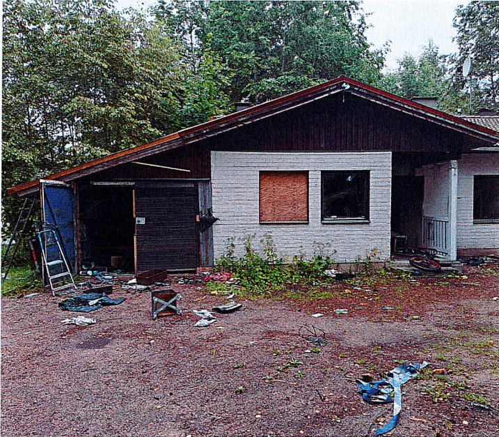
Kuva 1. Etupihalla on edelleen jätettä ja irtaimistoa. Ovet ja ikkunat ummistamatta.
