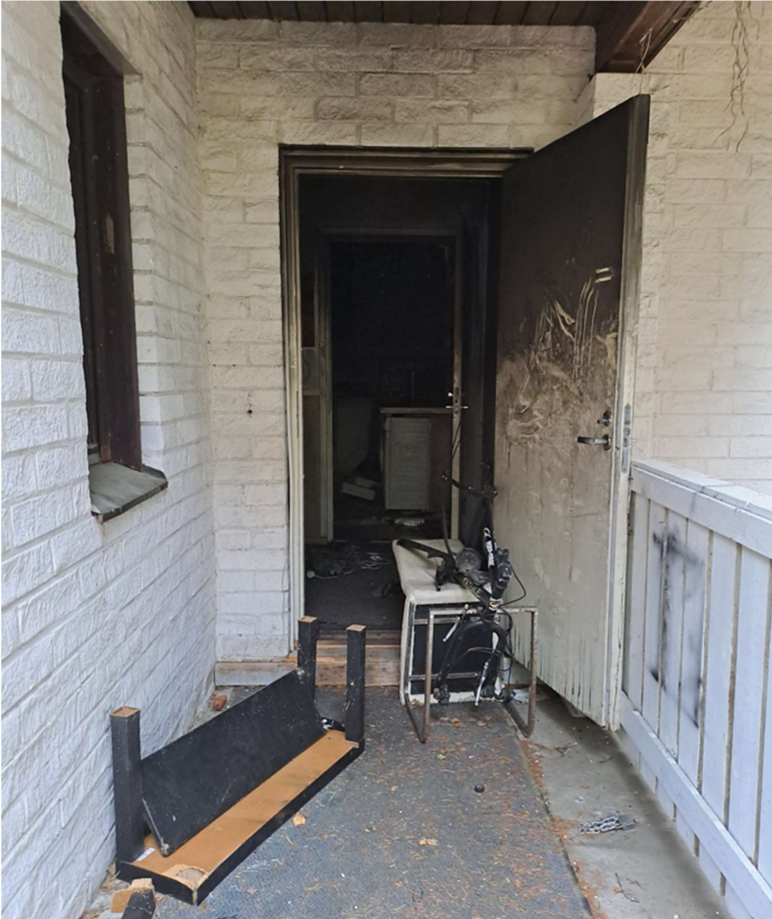
Kuva 3. Rakennuksen pääovi auki ja levällään.
