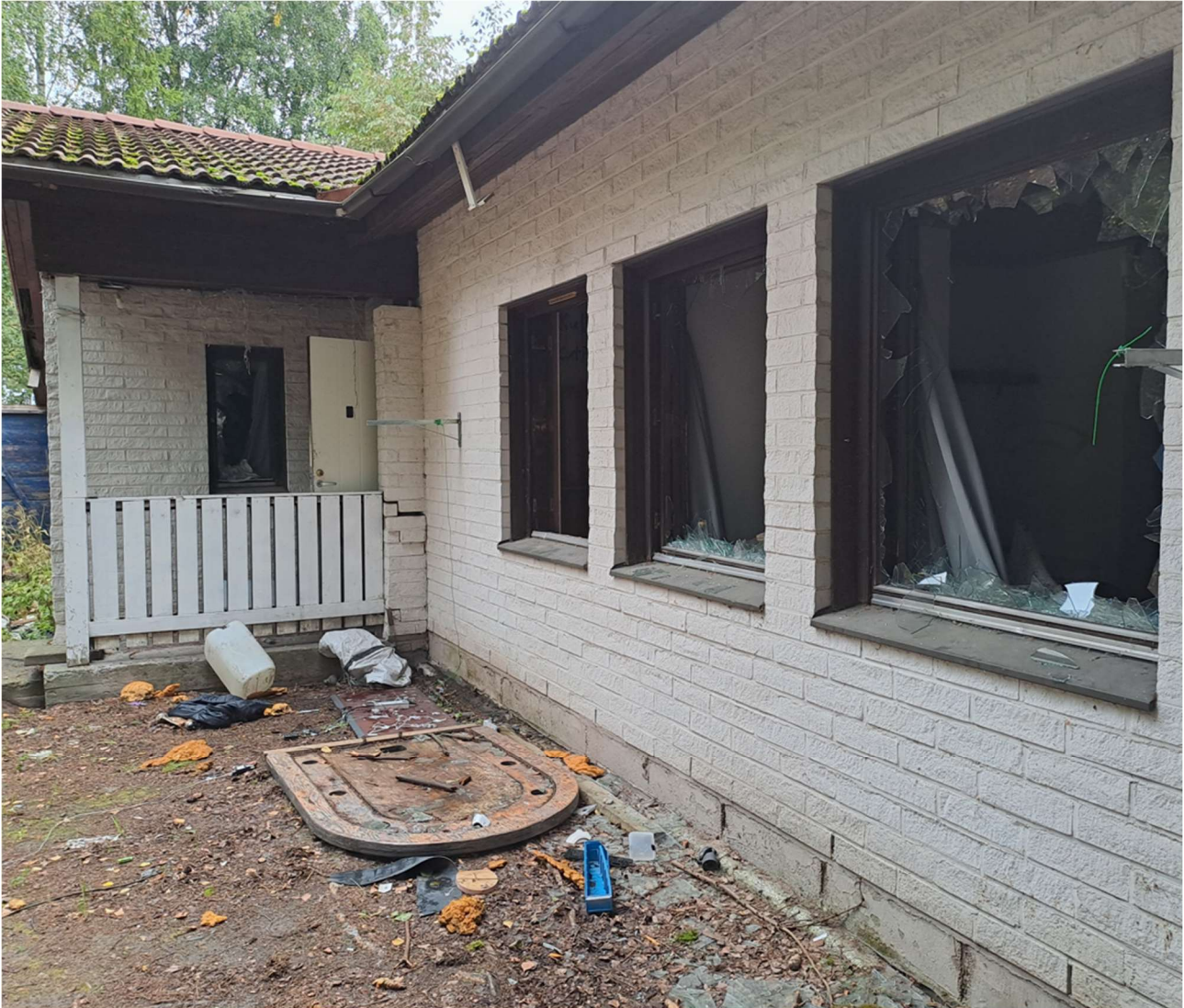
Kuva 2. Ikkunat rikottuina, ovet auki ja irtaimistoa pihamaalla.
