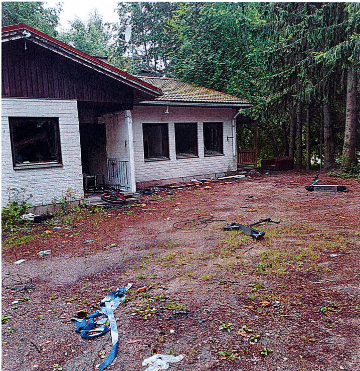
Kuva 2. Etupihalla on edelleen jätettä ja irtaimistoa. Ovet ja ikkunat ummistamatta.
