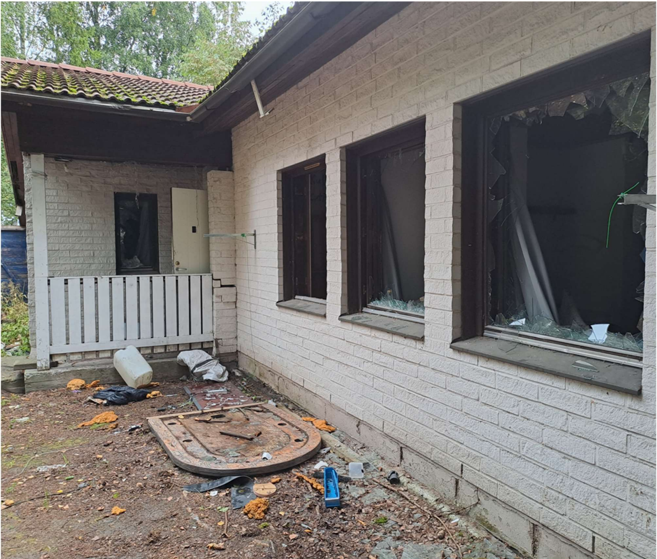
Kuva 2. Ikkunat rikottuina, ovet auki ja irtaimistoa pihamaalla.
