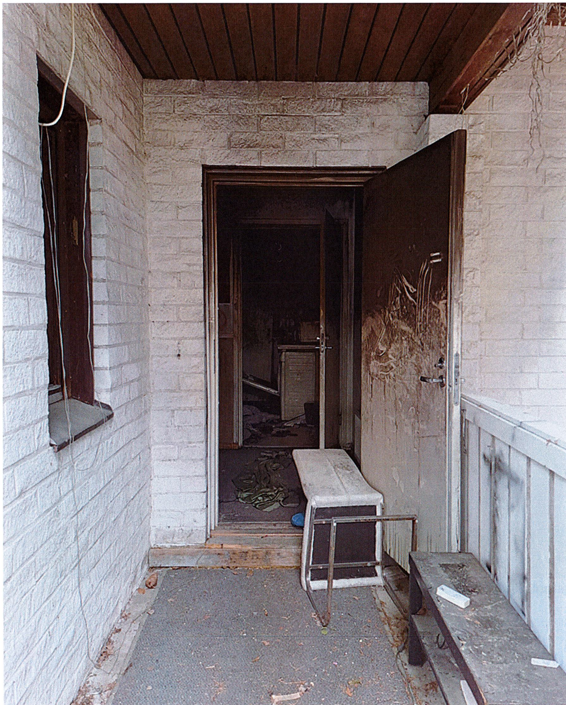
Kuva 2: Rakennuksen etuovi auki ja levällään.
